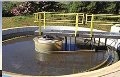
Tratamento de Efluentes
